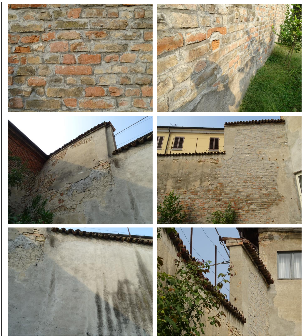
Figura 4 – Stato di conservazione della muratura in mattoni pieni (lato interno)
