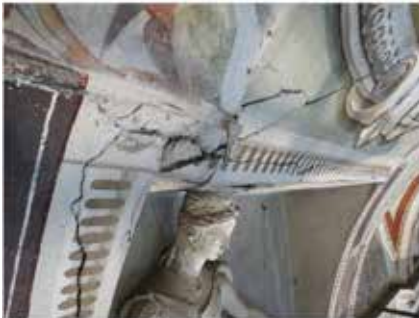
E fessurazioni, fratture e mancanze
