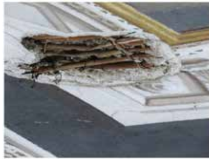
B caduta dell'intonaco della volta
