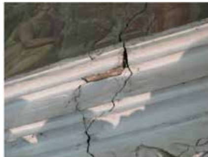
H fratturazioni e fessurazioni apparato decorativo in gesso
