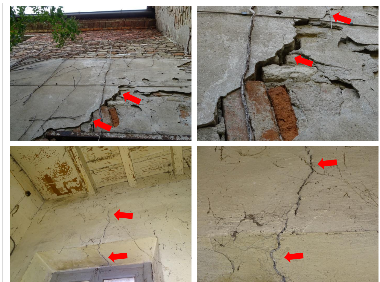
Figura 4 – Fessurazioni sub-verticali sopra le aperture
