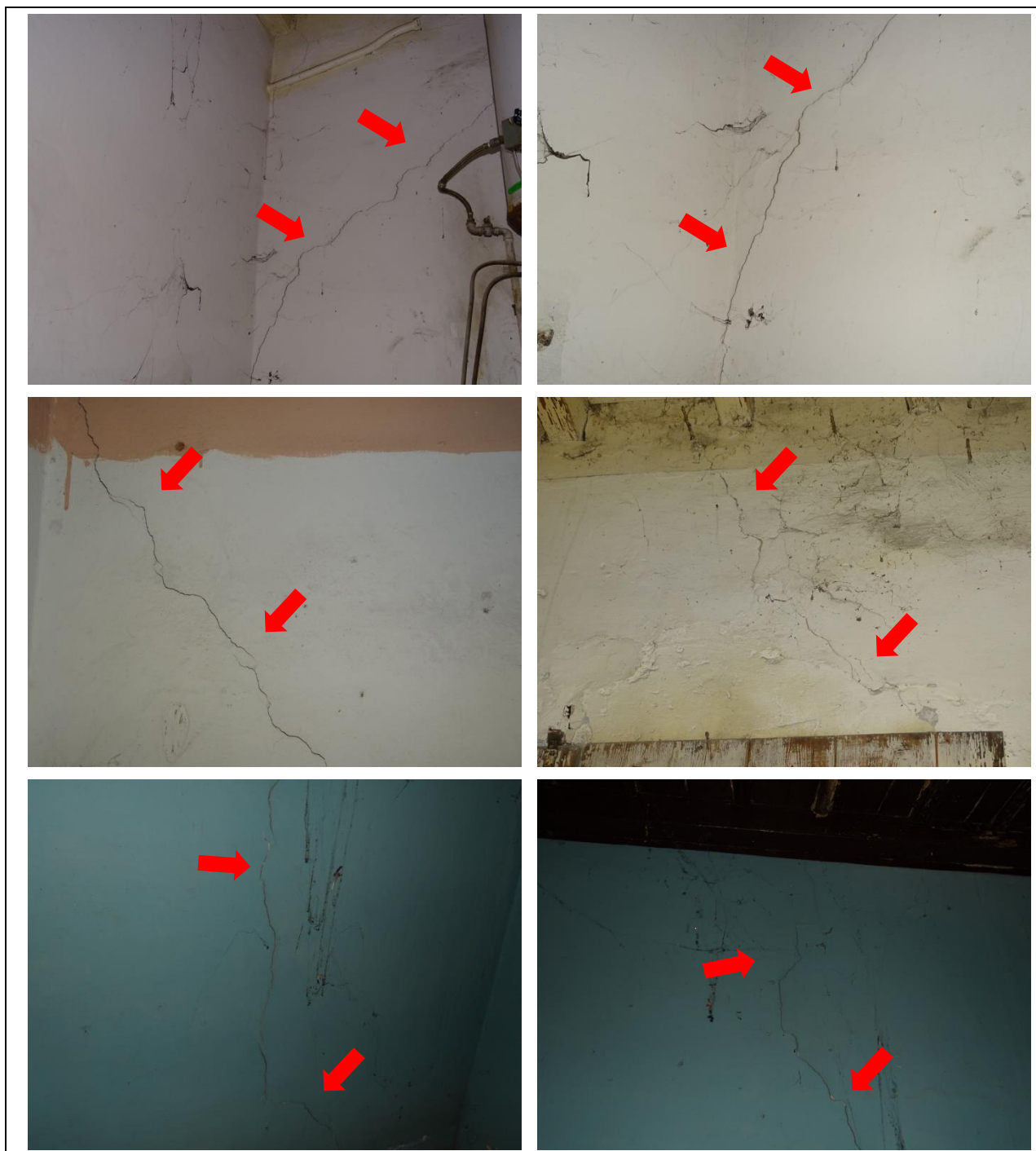
Figura 5 – Fessurazioni a 45° nelle murature portanti
